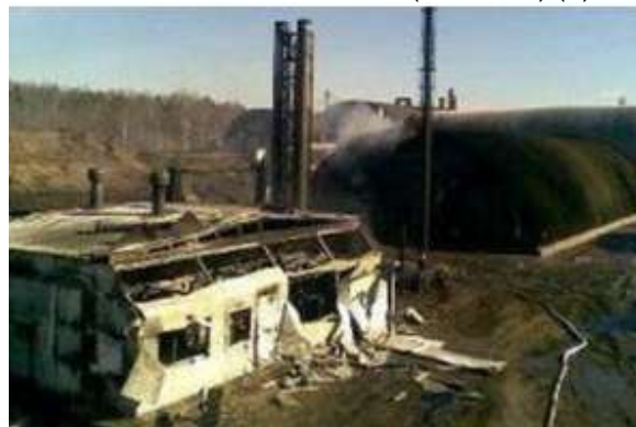
Foto 4 - Acidente em Joensuu (Finlândia) (b)
