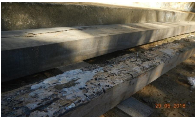
Figura 27 - Madeira danificada pelo gusano.
