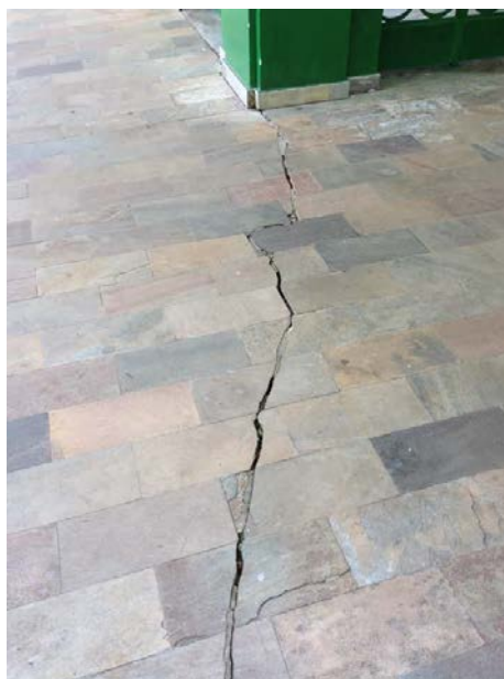
Figura 24 – Rachadura no assoalho do Parque de São Lourenço
