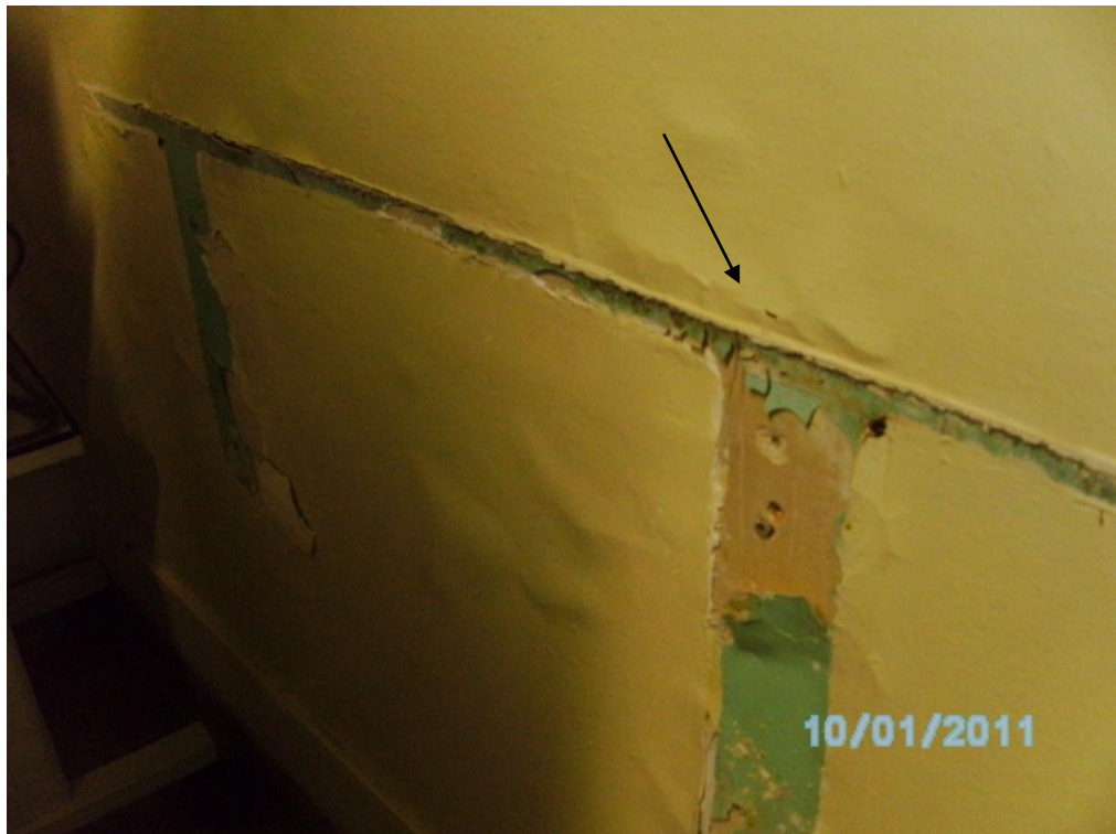
Figura 10 - Foco de infiltração em antessala cirúrgica
