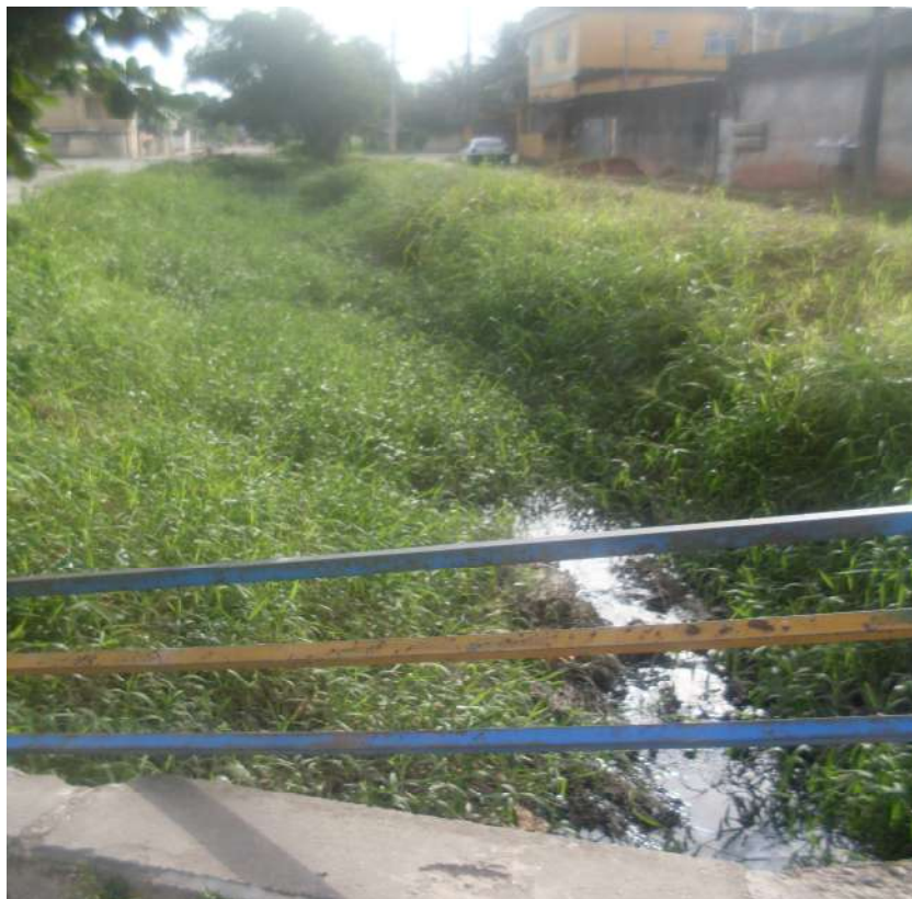
Figura 109 – Canal Farias assoreado e recoberto por mato em abril de 2013, Campos Elyseos, sub-bacia do rio Saracuruna, RJ
