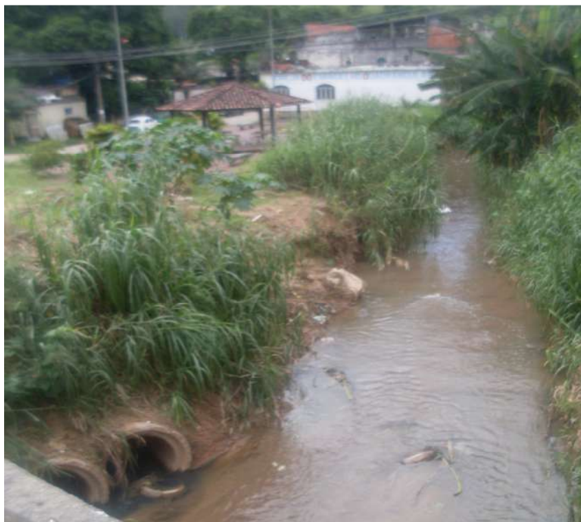
Figura 86 – Lançamento de esgoto no rio Santo Antônio, Distrito de Xerém, sub-bacia do rio Saracuruna, RJ
