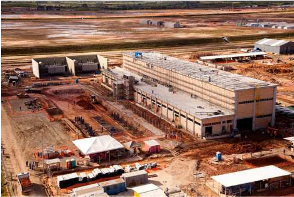
SUBESTAÇÃO PRINCIPAL MAIO/2012
