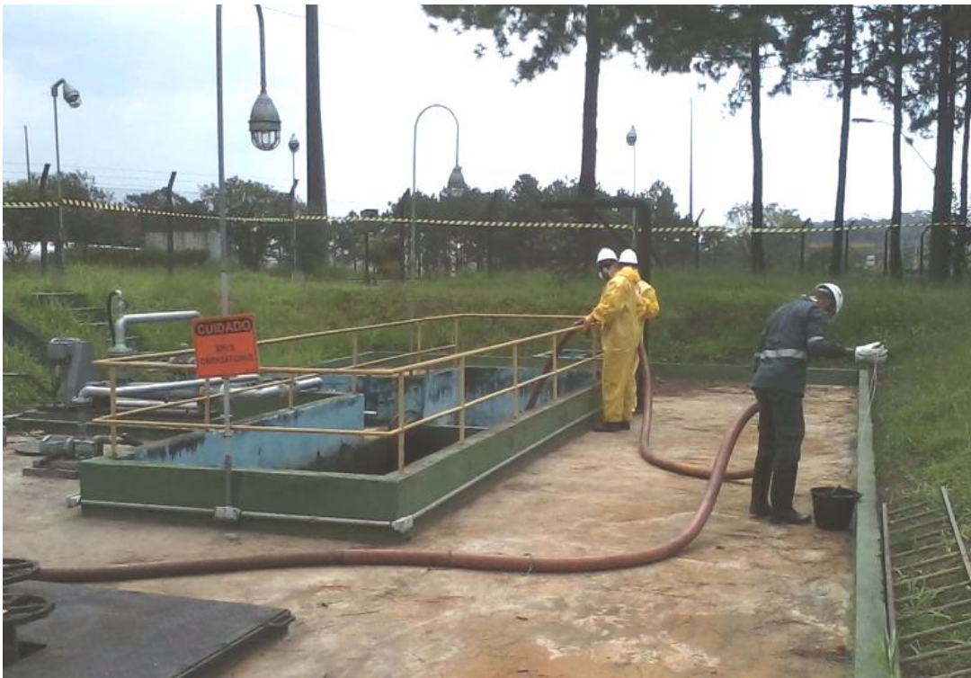
Figura 9 - Separador de Água de Óleo – SAO
