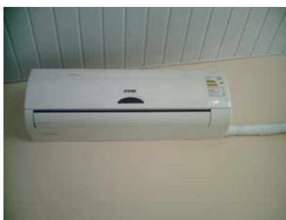
Figura 17 – Ar condicionado ligado
