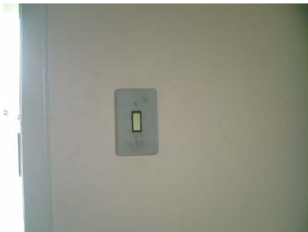
Figura 18 – Interruptores de luz
